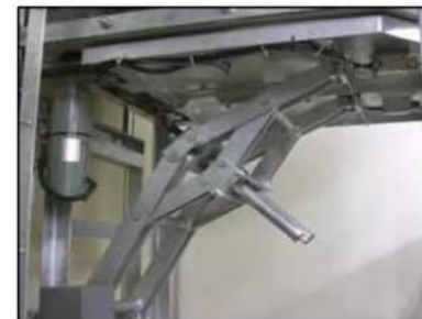
換気口浸水防止機
