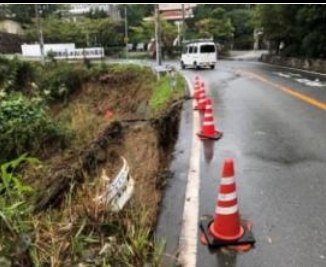
余野茨木線:路肩崩壊 (茨木市泉原)
