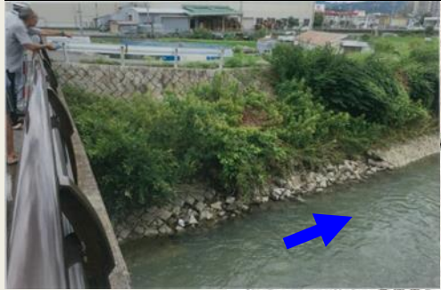
勝尾寺川巡礼橋下流左岸 護岸崩壊(茨木市宿川原)
