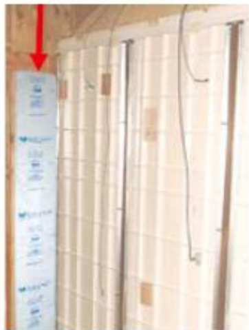
間違った施工
