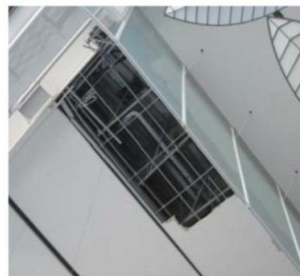
震災後の天井崩落の状況
