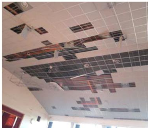
震災により落下した天井
