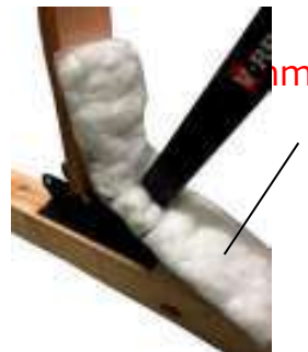
断熱材 (グラスウール)
