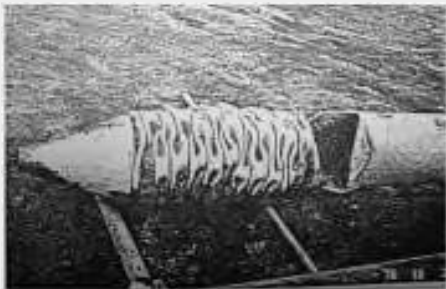
鋼管杭のちょうちん挫屈
