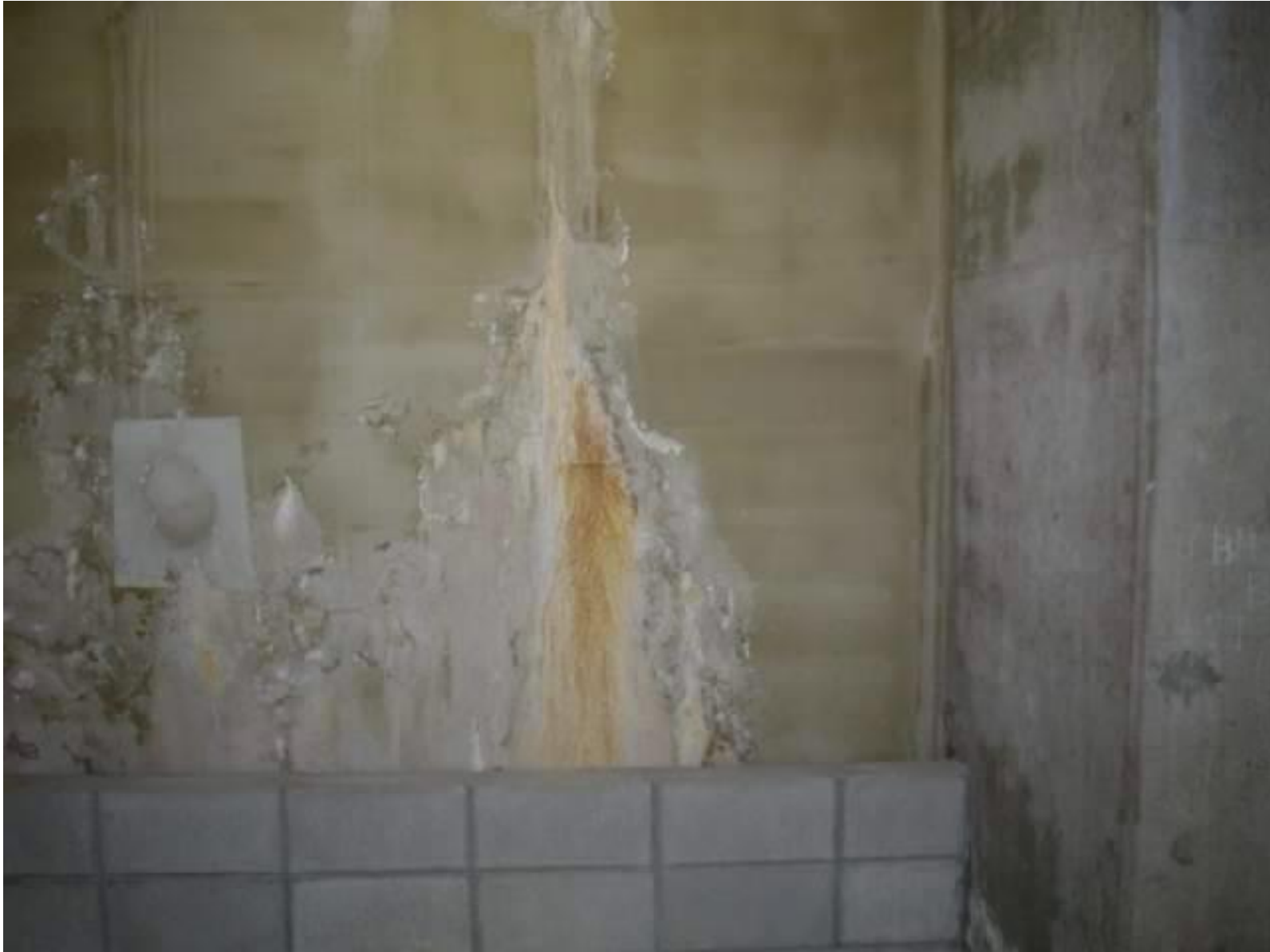
地下壁からの漏水
