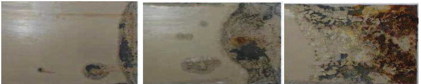
No.20 GL カー鋼板・防腐処理無し
