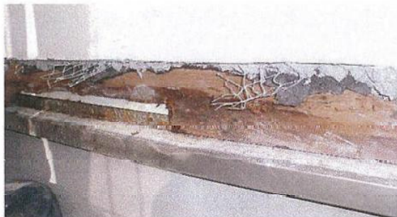
写真 1 水切りの腐食事例
