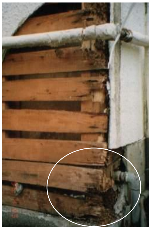
配管付近の結露が原因と思われる腐朽・蟻害
