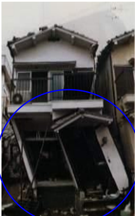
間口2間の狭小住宅の被害例
