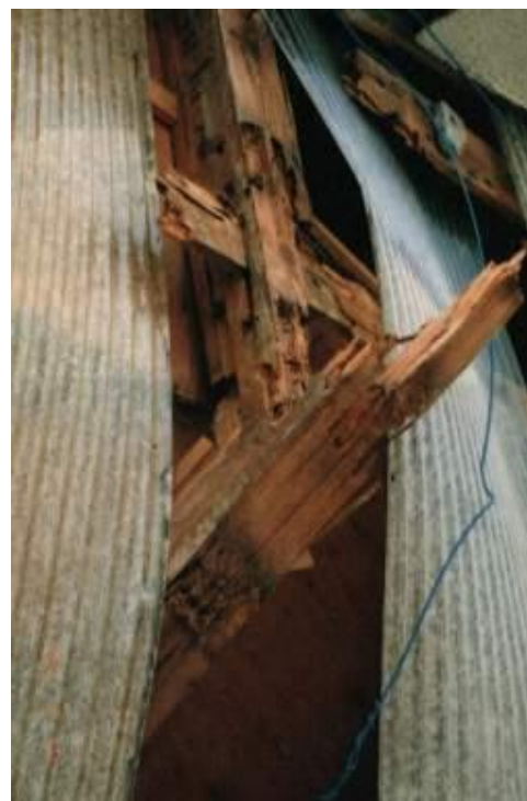
蟻害にあった柱が地震により折れてしまっている
