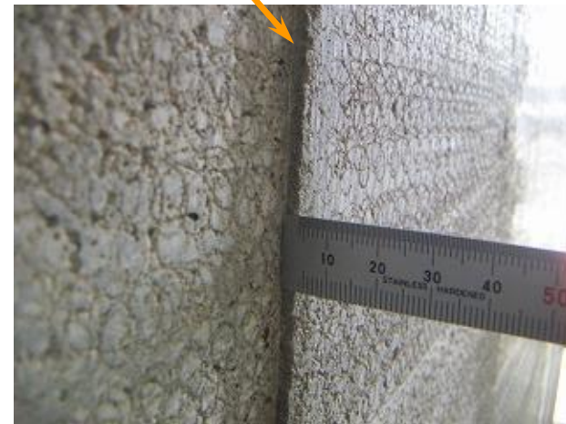
型枠パネルの目違い
