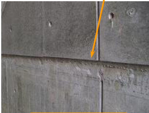
水平打継ぎ部の段差
