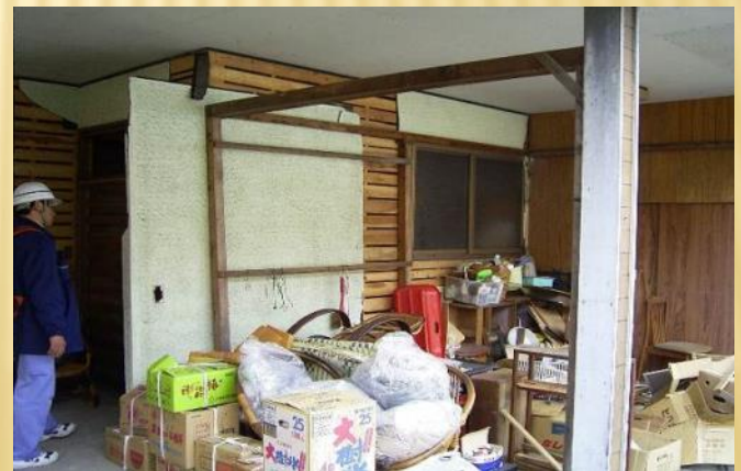
ステープルの基準以下使用による外壁の剥落
