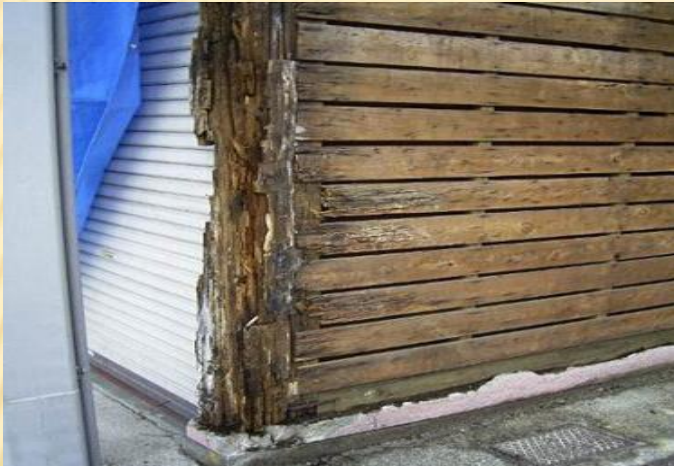
雨水侵入による劣化
