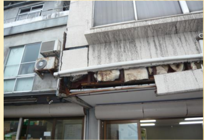
壁内結露による劣化
