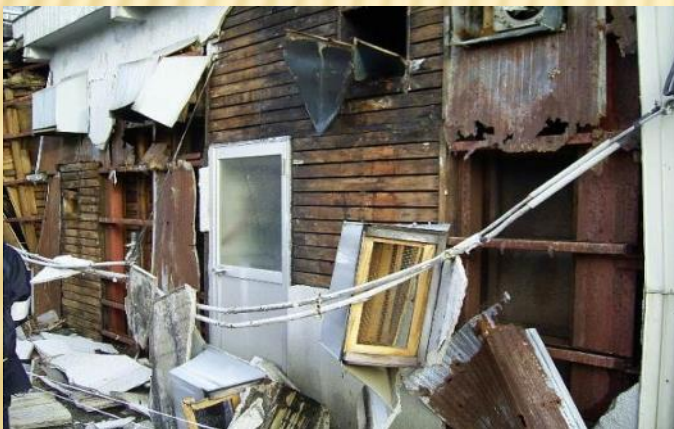
複合下地の劣化
