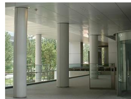
吹付けロックウール+アルミパネル (外径φ512mm)
