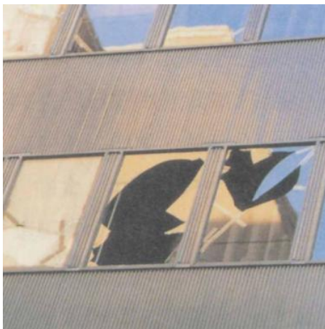
(b) 外壁のガラスの破損
