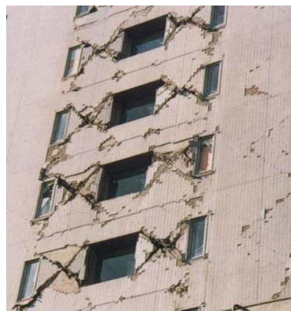
(c) 外壁タイル落下
