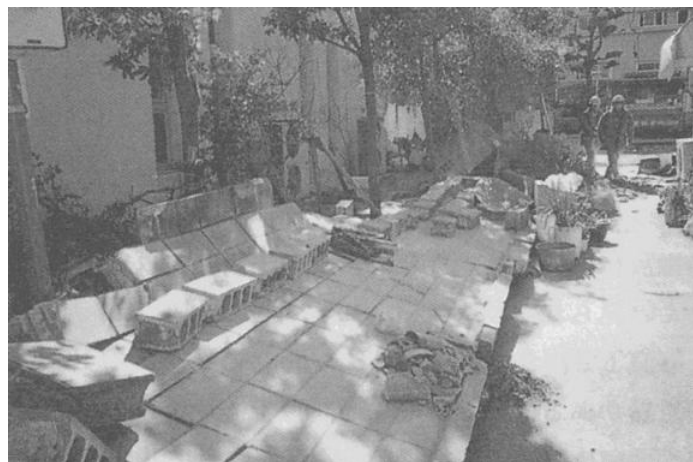
(a) ブロック塀の転倒
