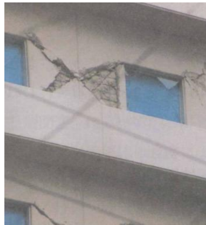
(b) 外壁のせん断ひび割れ
