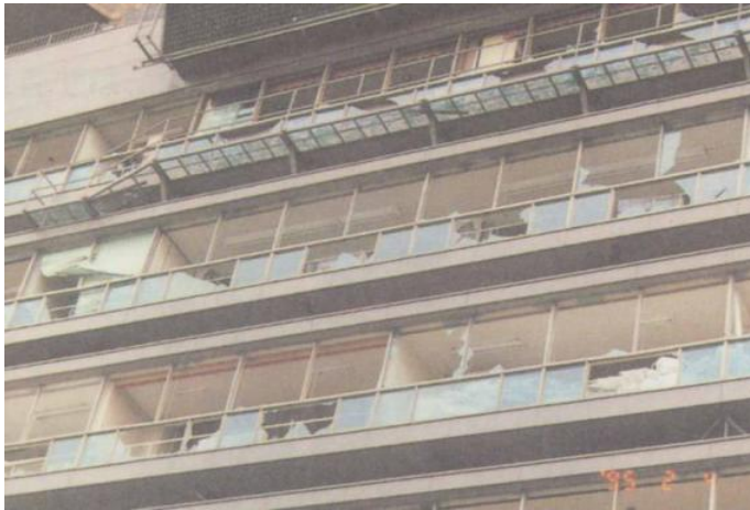
(a) パテ止めされたガラスの破損
