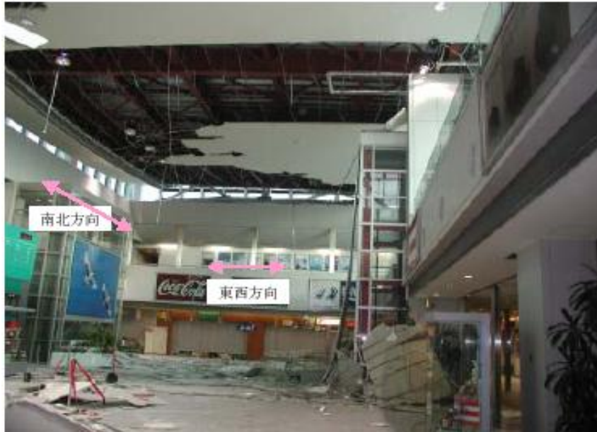
図-6 天井の落下
