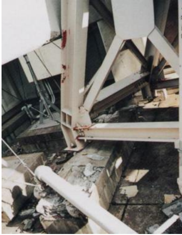
(a) アンカーボルトの破断
