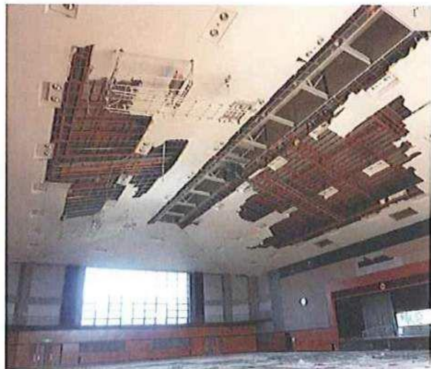
写真 5.6-39 在来工法による天井の脱落被害
