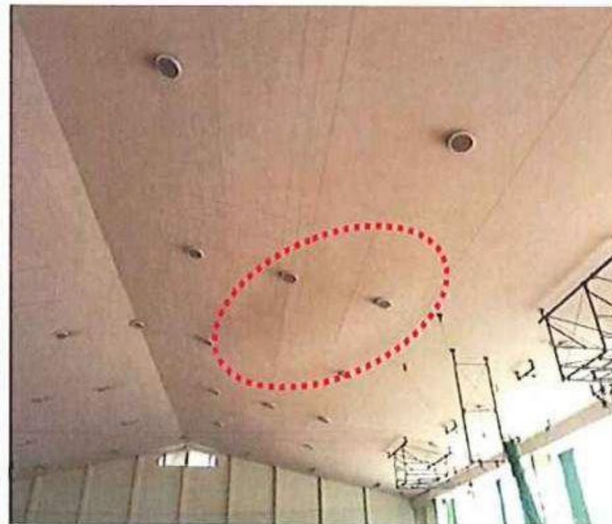
写真 5.6-41 在来工法による天井の天井面の異状
