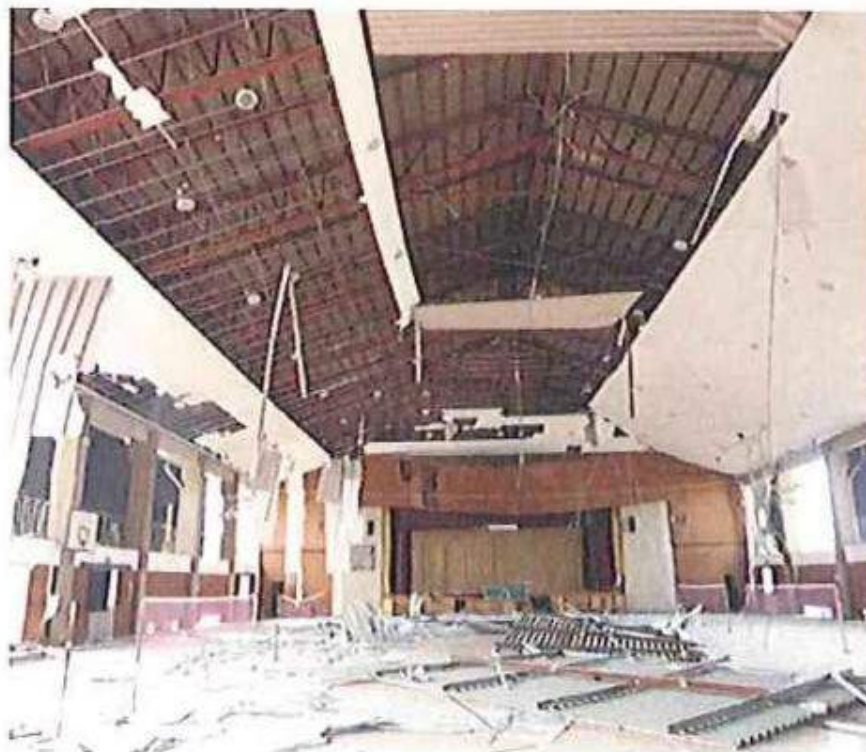
写真 5.6-40 在来工法による天井等の脱落被害
