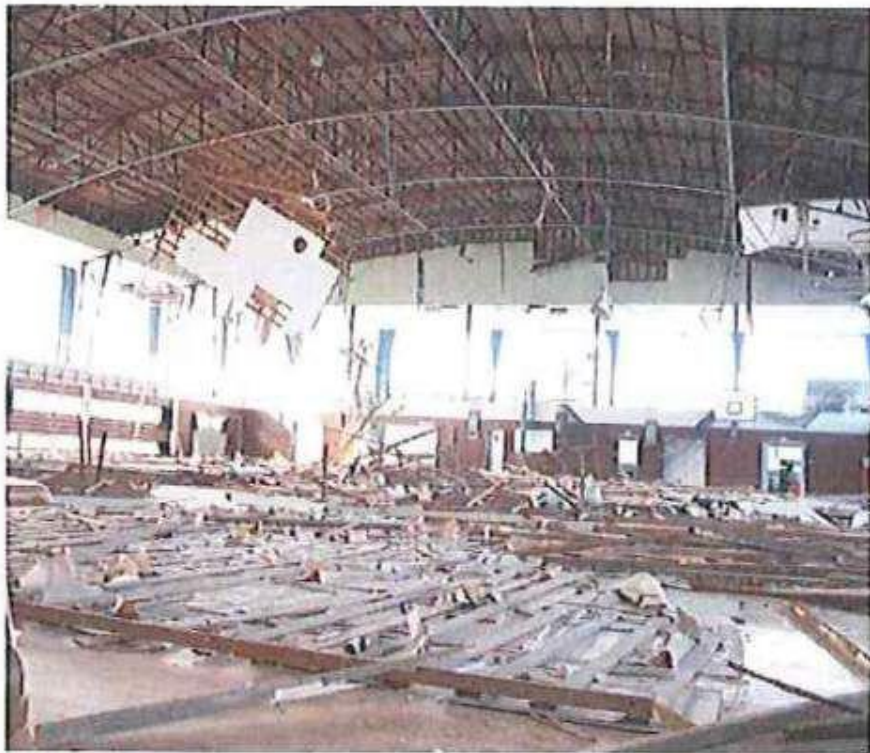
写真 5.6-38 木下地による天井の脱落被害
