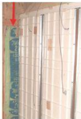
間違った施工
