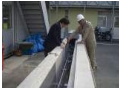
床上配管ピットのモックアップ
