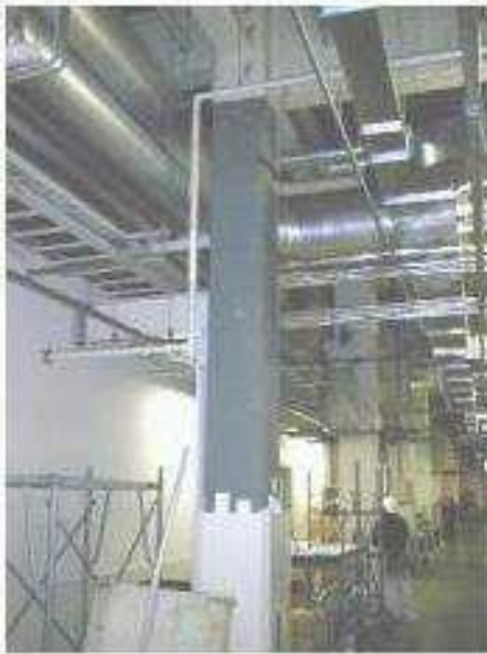
成型板の破損・脱落
