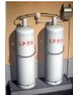
ガスボンベ転倒防止装置
