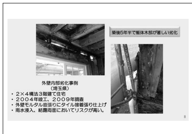
図1 高気密高断熱非通気構法住宅の外壁内部劣化事例
