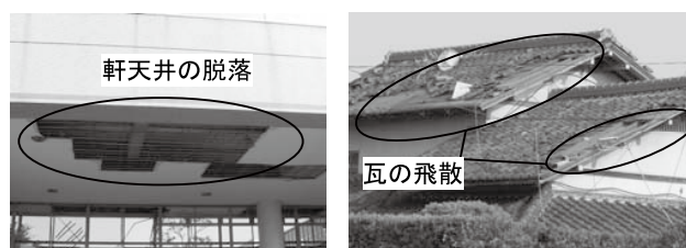
軒天井の被害事例
