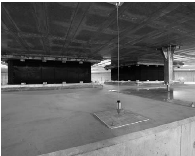
躯体と基礎の間にある免震層
