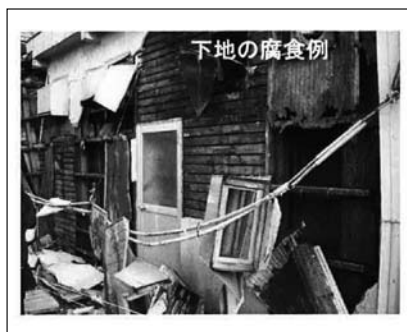
図2 下地の腐食例
