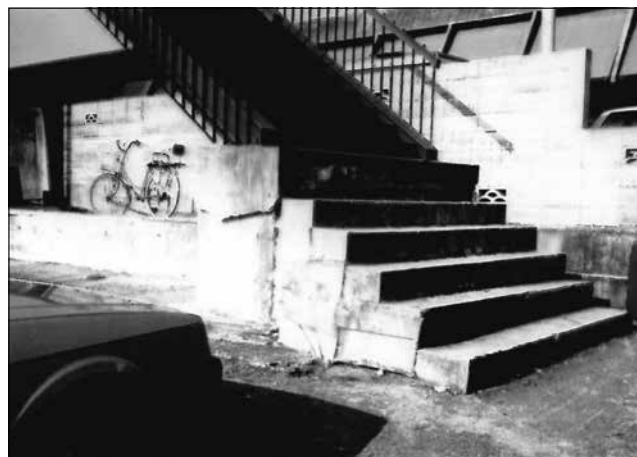
図5 地盤沈下による階段部の継ぎ足し
