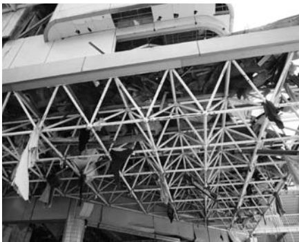
写真34 上のスーパーの近影。がれきは撤去されたものの、ひさしには流されたゴミが大量にひっかかったままだった。(2012年7月29日)
