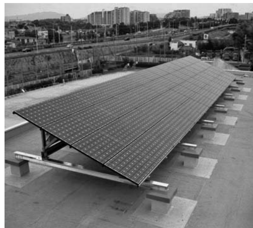
学校の屋上に設置された太陽光発電システム
