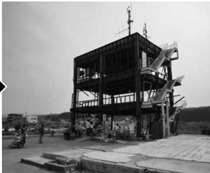
写真18 鉄骨だけの無残な姿になった防災対策庁舎は、取り壊されずそのままだった。周囲の住宅は流され、殺風景な眺めが広がる。(2012年7月29日)
