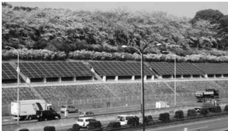
万博公園に設置された太陽光発電システムも同社が手がけた
