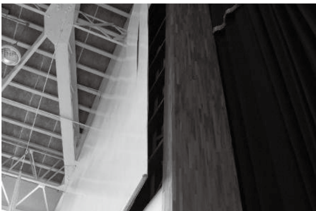
写真-16 ビスの長さ不足による内装材の外れ
