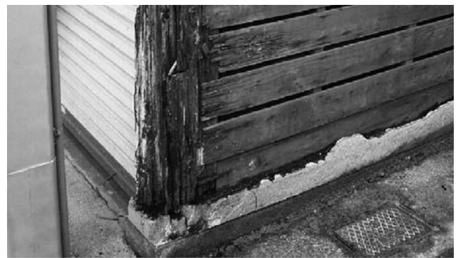
写真-1 生物劣化が原因の外壁剥落例
