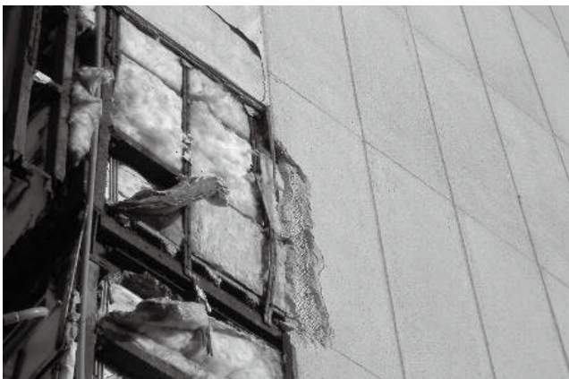
写真-15 鉄骨下地腐食によるALCの脱落
