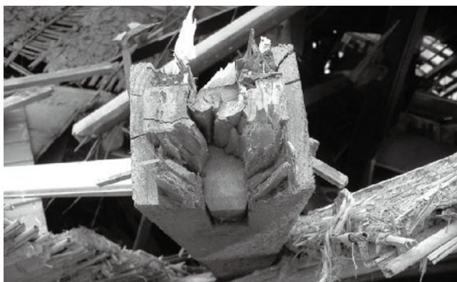
写真-4 ホゾ部分で折れた柱
