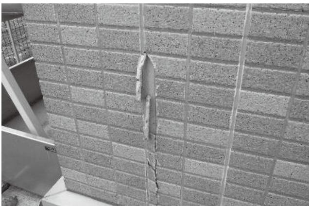
写真-14 RC構造目地部のタイル剥落
