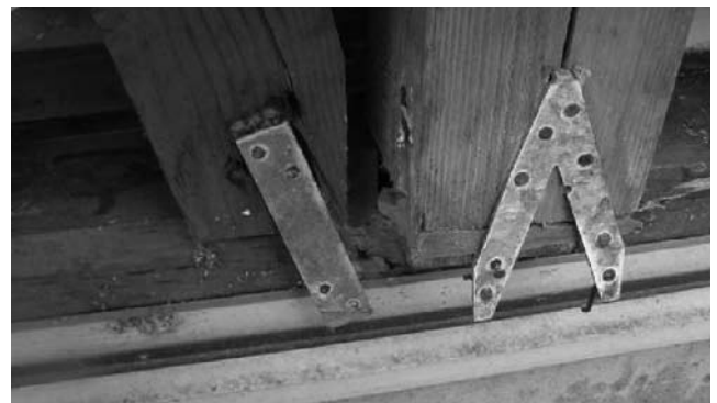
写真-2 間違った施工例
