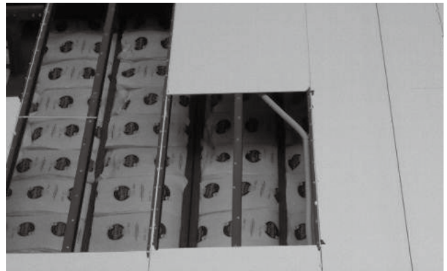
写真-18 ケイ酸カルシウム板内壁の脱落
