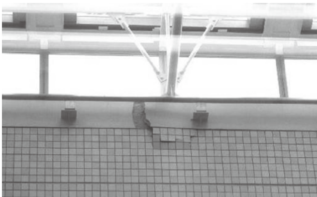
写真-8 鉄骨造屋根アンカー部の被害例
