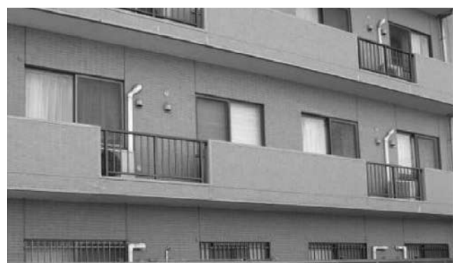
写真-20 3方向スリットの効果例 参考写真-1の隣の建物
