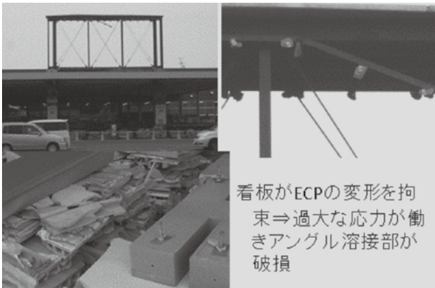
写真-13 ECP上の看板の脱落
