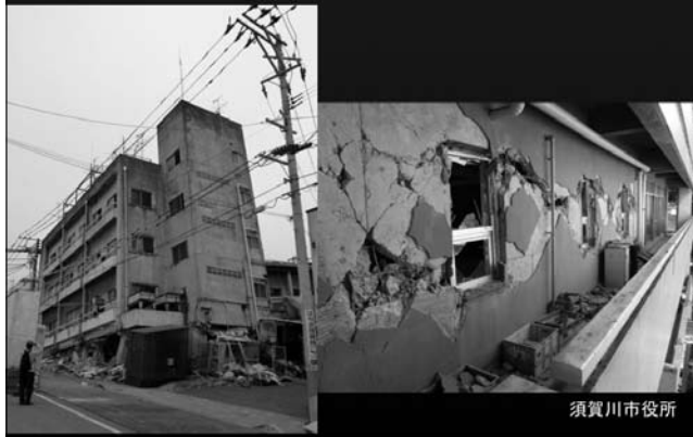
図4 地震動によるRC建築の被害
