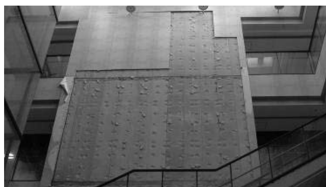
写真-11 ECP上の化粧パネルの脱落
