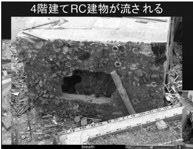
図6 津波で流されたRC建物
