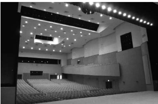
写真-24 壁との間に隙間を設け触れ止めを設置し、軽微な損傷で済んだ例
