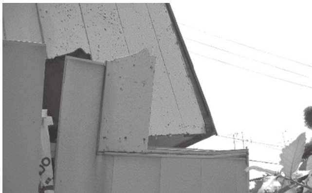
写真-5 金物不良で2階部分で外れた柱
