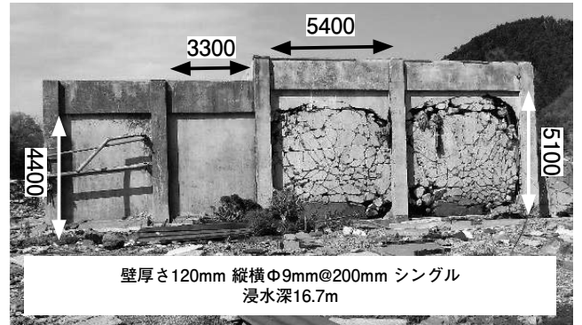
写真-23 面外方向の剛性の違いによる損傷度の差
