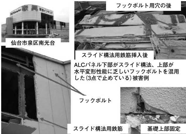
写真-12 ALC 外壁の被害例
