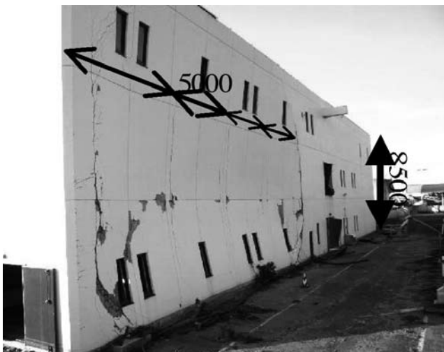
写真-21 津波の波圧による面外方向への変形例
