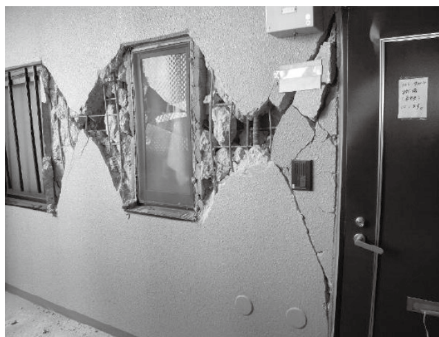
写真-1 構面内の非構造壁の被害例
