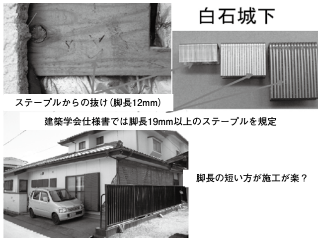
写真-10 ラスモルタル外壁の被害例(ステーブルの抜け)
