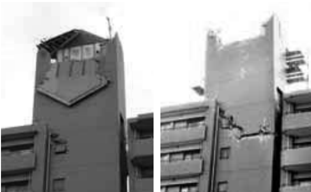
写真-5 震災直後(左)と余震後(右)のエレベータ棟の被害例
