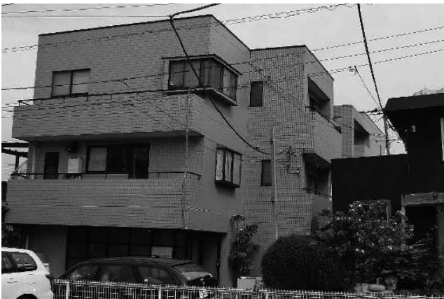
写真-7 液状化による建物の傾斜
