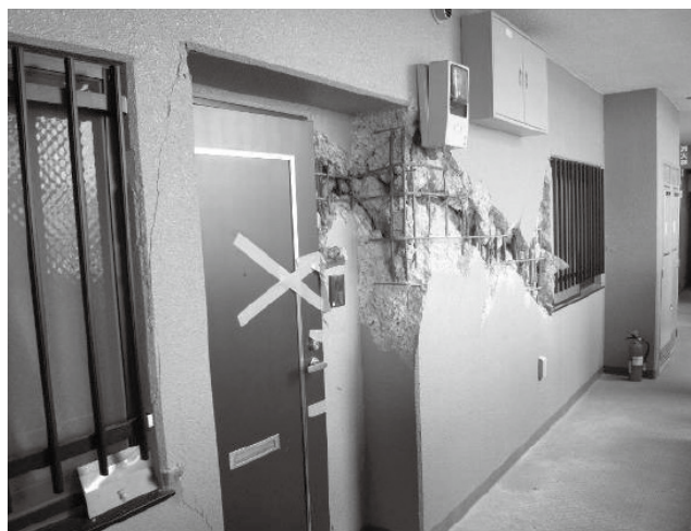
写真-2 構面外の非構造壁の被害例
