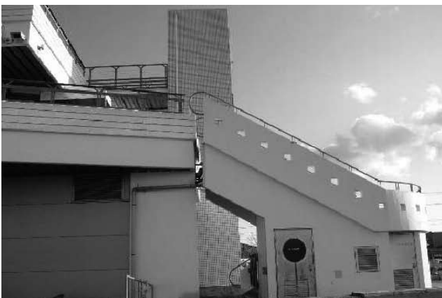
写真-8 基礎の違いによる段差が生じた階段
