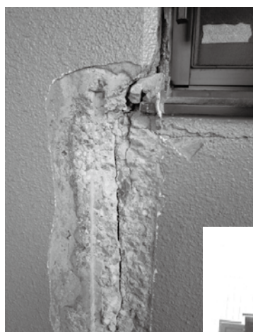
写真-3 完全スリット表面 モルタル下地部の被害
