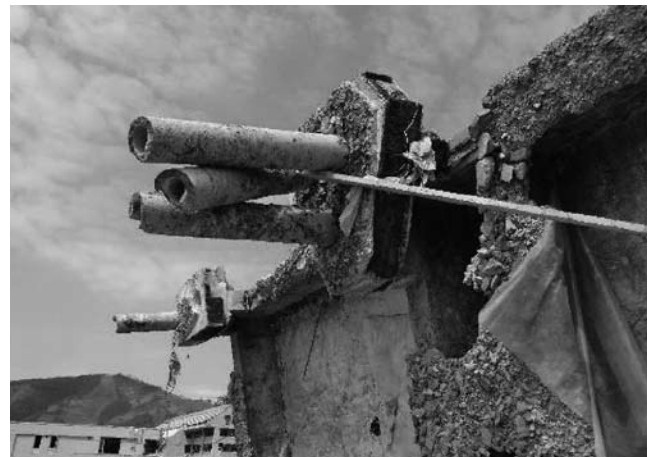
写真-24 杭が曲げ破壊し転倒した建物
