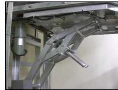
換気口浸水防止機
