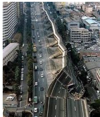
高速道路の倒壊 （阪神・淡路大震災）
