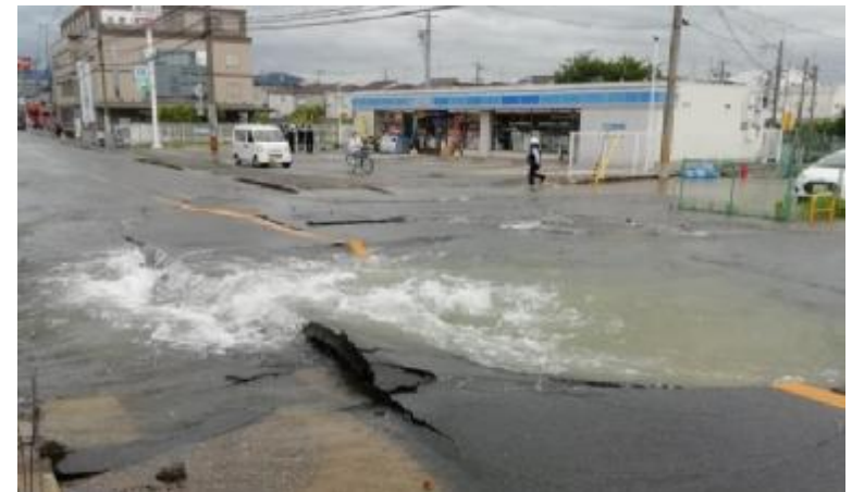
水道管が破断して水が噴き出した道路 (高槻市提供)
