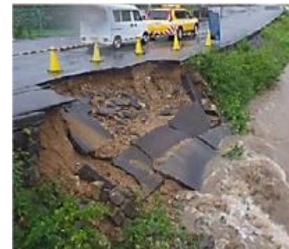
護岸崩壊（平成30年7月豪雨）
